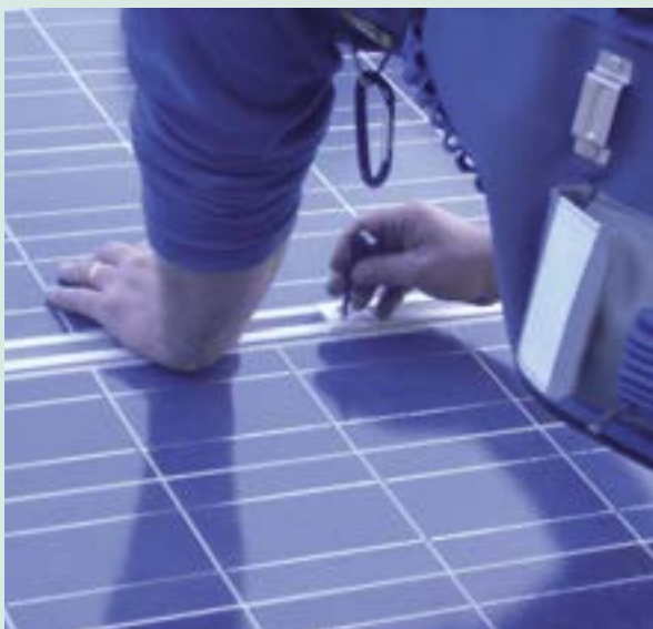
Fin juin 2009, le parc photovoltaïque français représentait 135 MW pour environ 25 000 installations
