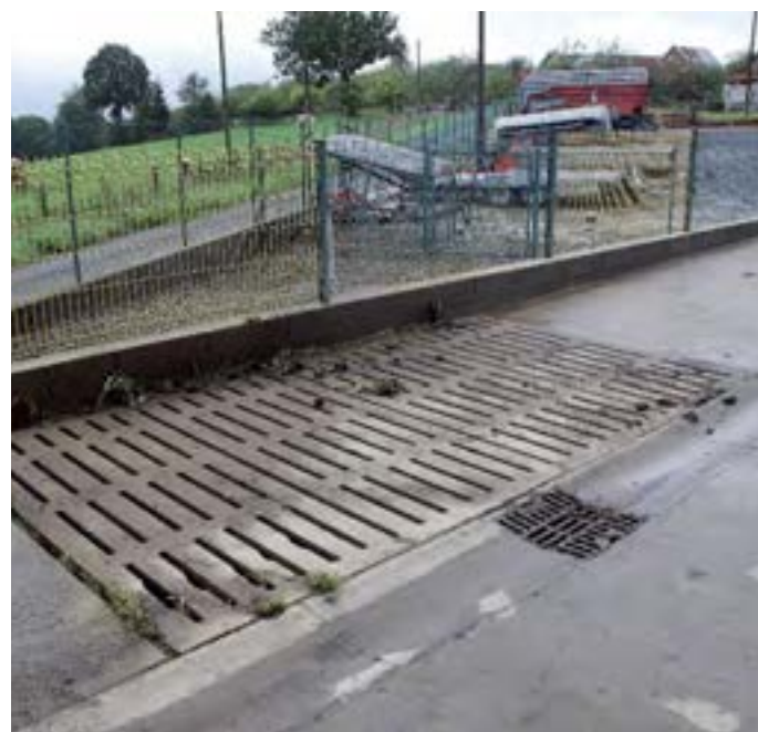
En 2003, l'entreprise a mis en œuvre les équipements nécessaires au traitement des eaux usées issues du lavage des engins agricoles.
