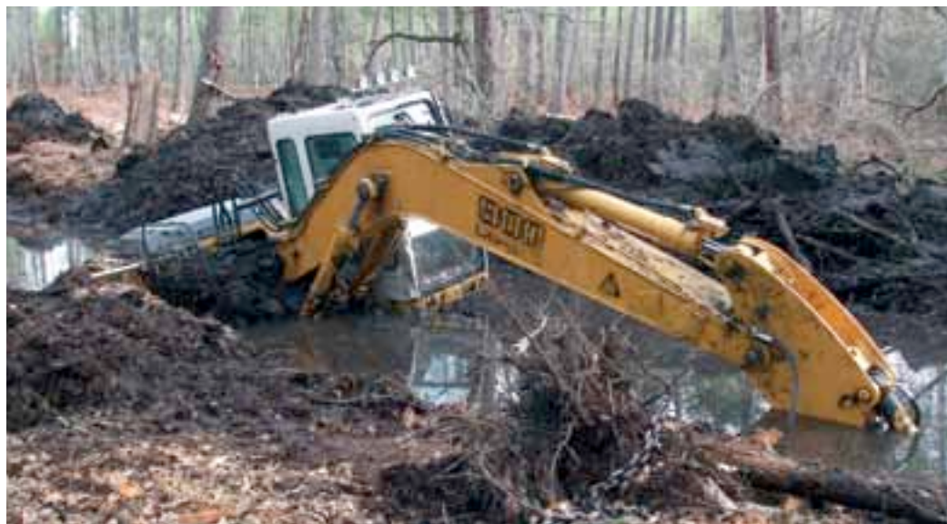
La pelle mécanique d'un entrepreneur du Sud-Ouest, venu aider un collègue qui avait embourbé son abatteuse, s'est retrouvée elle-même embourbée. La machine a fini à la casse.
