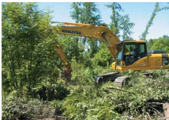
Pelle et bulldozer sont les matériels adaptés pour ce type de chantier.
