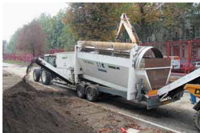
Un des derniers matériels investis par la STC Courtois est ce cribleur qui a servi notamment sur ce chantier dans un parc urbain à Lille.
