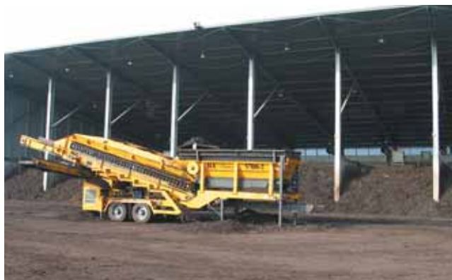
La station de compostage comprend un bâtiment couvert avec plusieurs silos de maturation. Au premier plan, le cribleur.
