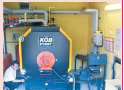
Un exemple de chaudière collective dont plus de mille ont été installées en France depuis 12 ans.
