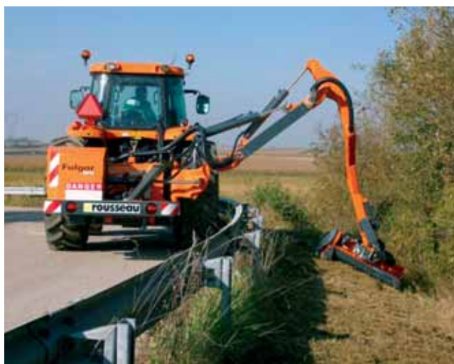
Grâce à Démoroute, les utilisateurs peuvent découvrir les dernières évolutions des matériels d'entretien des accotements routiers en situation.
