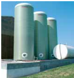
Ces trois cuves (montées sur un bac de rétention de 60 m 3 ) contenant l'engrais liquide sont en fibres de verres. Cette matière ne craint pas d'altération par l'azote, contrairement au métal.
