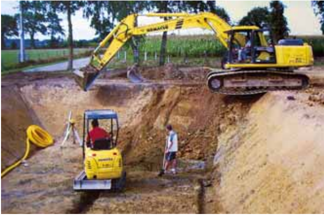
Les prestations de TP (terrassement, assainissement) sont un bon complément d'activité. Ici, réalisation d'une fosse géomembrane pour la récupération de lisier.
