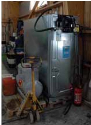
Le tout récent réservoir à fioul de 1 500 litres.
